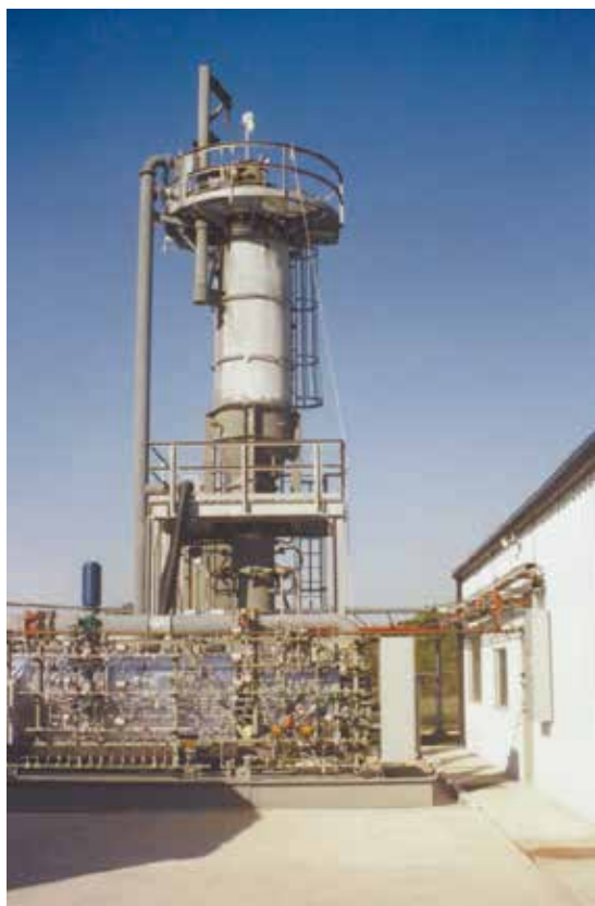
霍尼韦尔 UOP 凯勒特研发测试中心的顶烧式氧化炉
