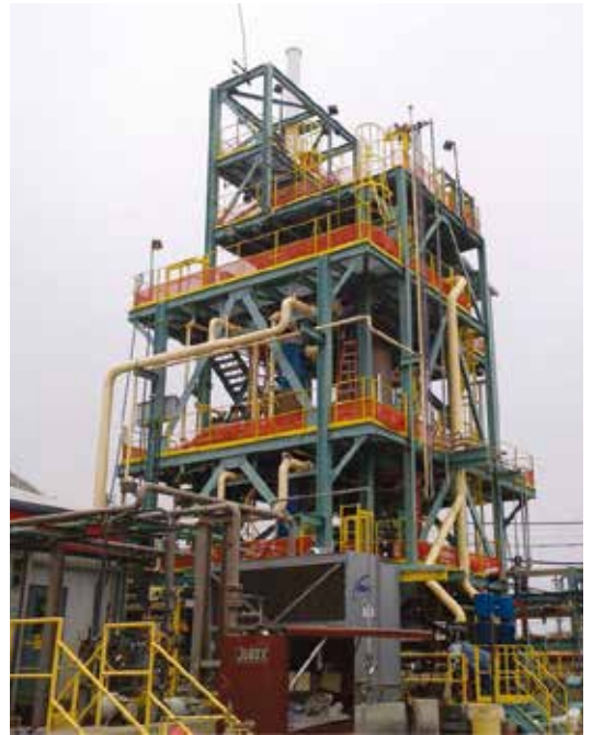
含卤废弃物热氧化炉
