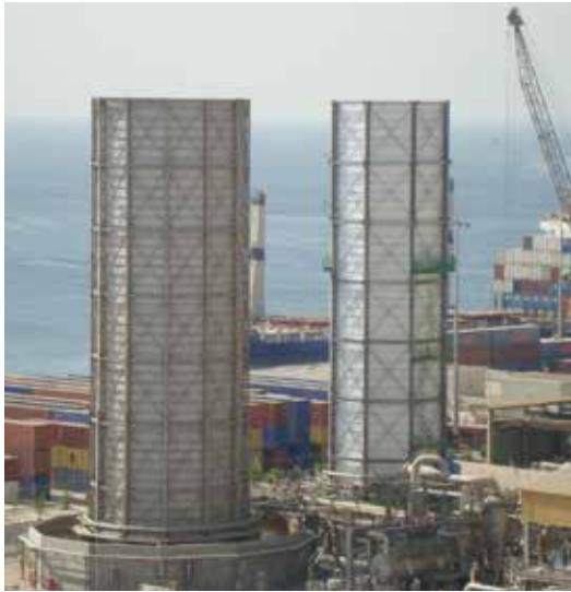
全封闭式地面火炬 (TEGF)
