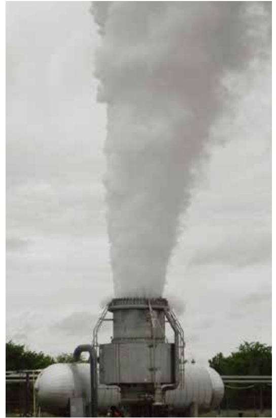
内部蒸汽火炬头高蒸汽流量测试
