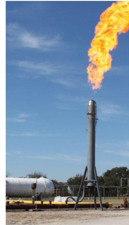
连续吹扫系统
