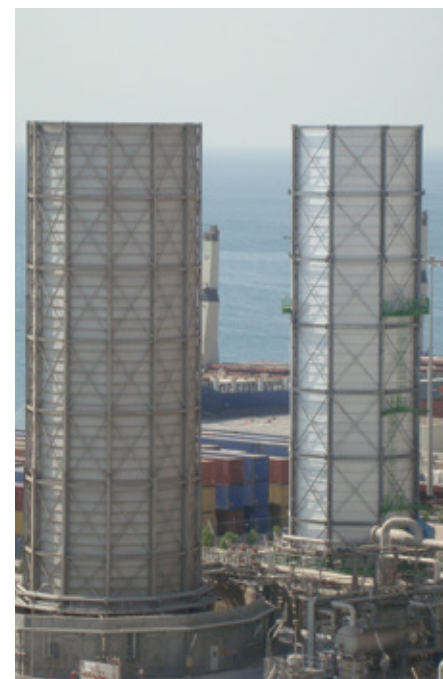
全封闭式地面火炬
